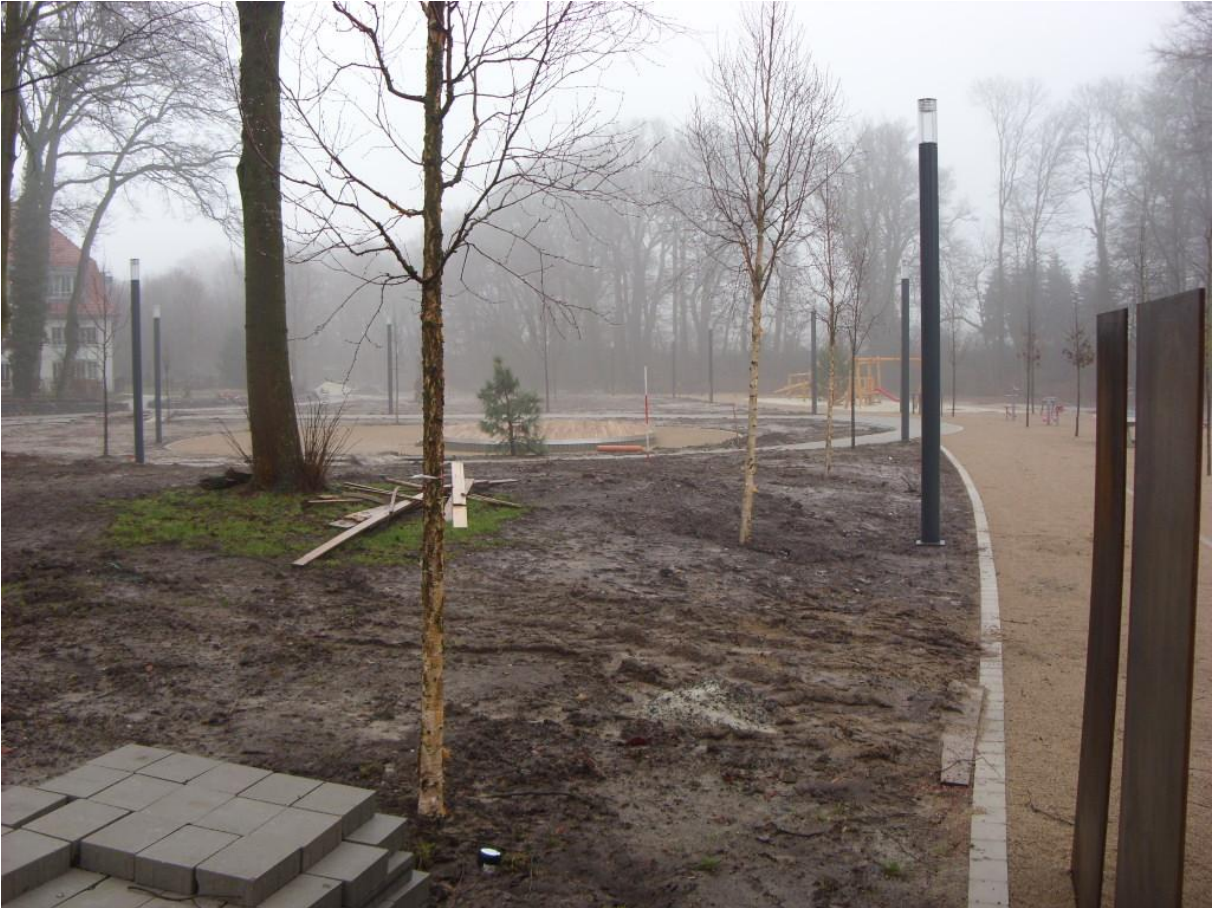
Blick in den zukünftigen Mehrgenerationenpark - Die Bauarbeiten sollen im Frühjahr 2013 abgeschlossen werden.
